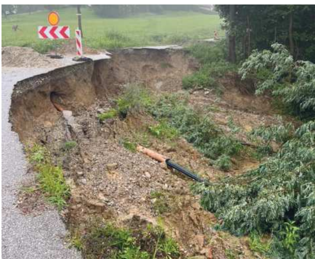
Zemeljski plaz v Oseku je odnesel cesto.
